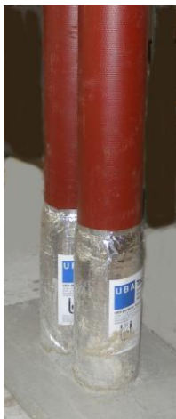
Bild 6: Rohr ohne Rohrverbinder in der Decke
